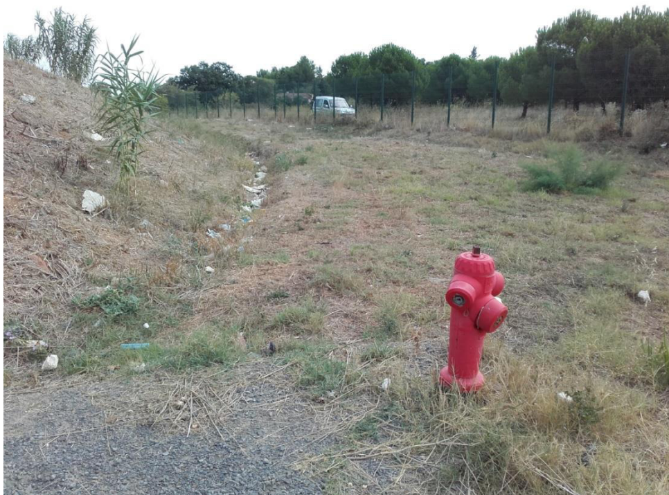
Figure 11 : Borne incendie à l'entrée du site au niveau du casier n°1
